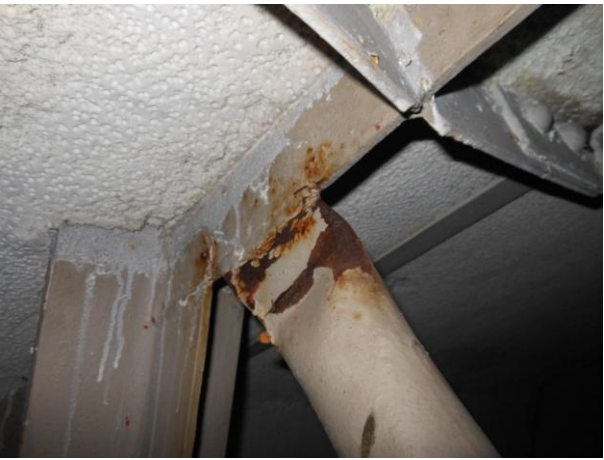
トラスNo.16 ラチス材座屈
