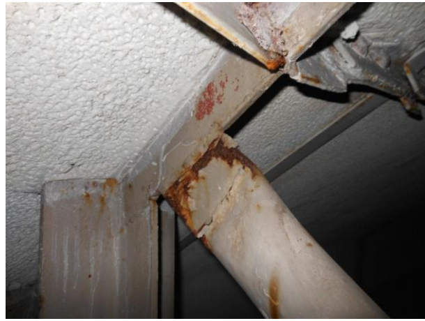
トラスNo.24 ラチス材座屈
