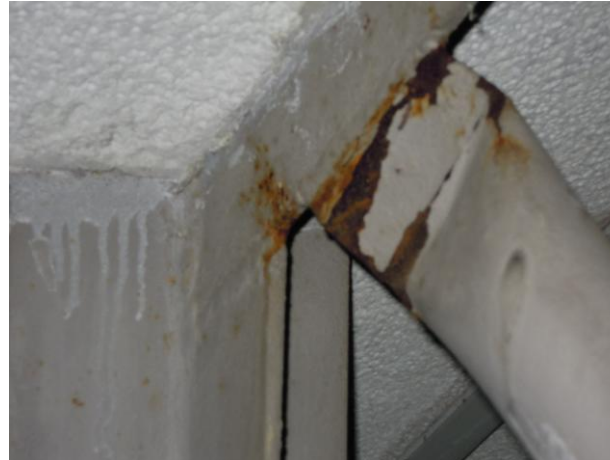
トラスNo.18 ラチス材座屈
