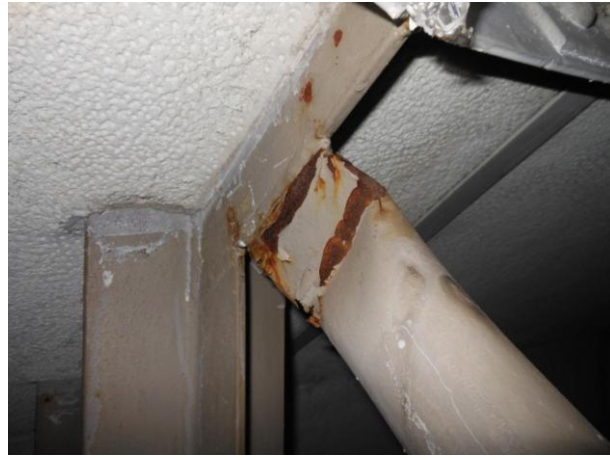
トラスNo.19 ラチス材座屈
