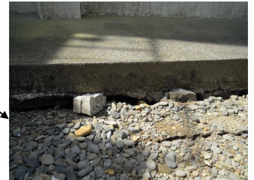
犬走りの一部陥没
