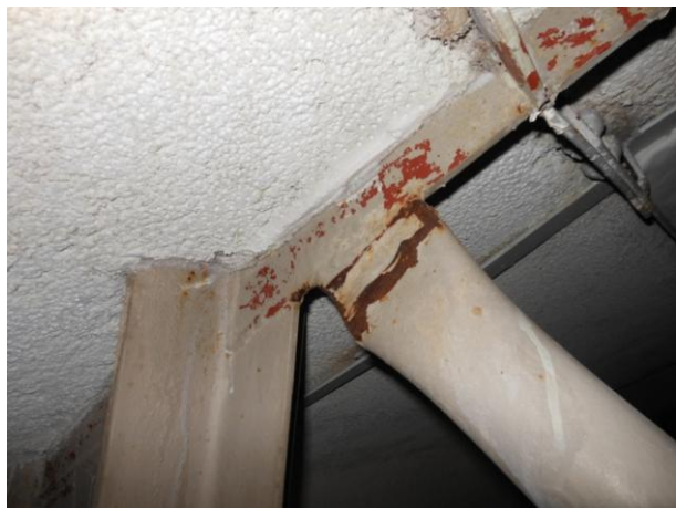
トラスNo.12 ラチス材座屈
