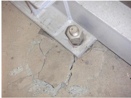
純水製造装置の基礎ボルト埋め込み部周辺コンクリートのひび割れ
