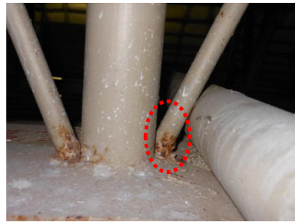
② 頂部リングとラチス材の溶接部 (下弦材No.1付近)
