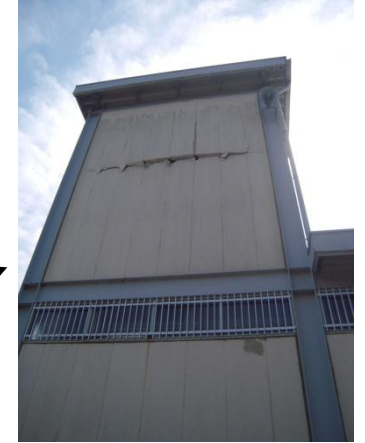
外壁(ALC)の一部損傷
