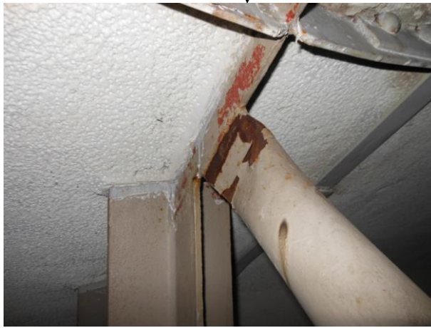
トラスNo.14 ラチス材座屈
