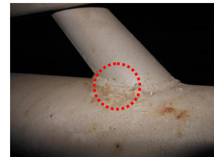
⑩ 下弦材No.32とラチス材の溶接部
