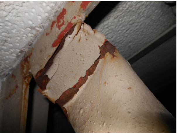
トラスNo.13 ラチス材座屈
